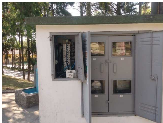
Foto 01 – Foto do quadro de energia mais próximo dos locais sugeridos, com 3 relógios disponíveis.
