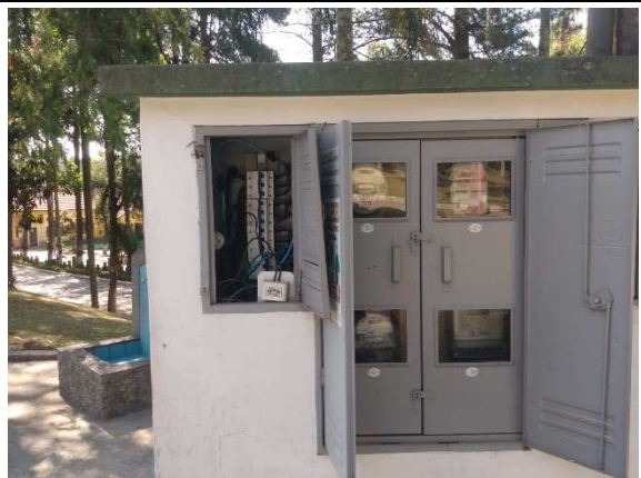
Foto 03 – Foto do quadro de energia mais próximo dos locais sugeridos, com 3 relógios disponíveis
