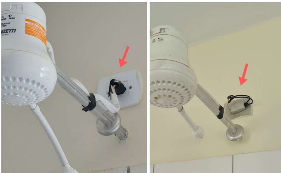
Imagem: Ligação elétrica inadequada nos chuveiros
