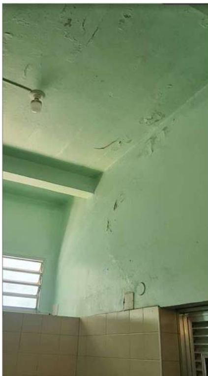
Imagem: Teto - umidade
