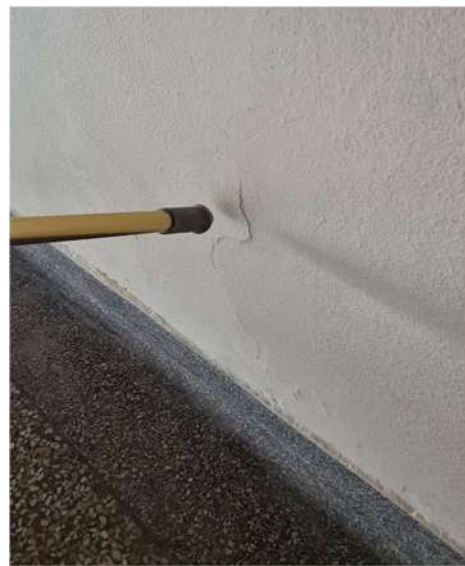
Imagem: Pintura solta/ fissuras
