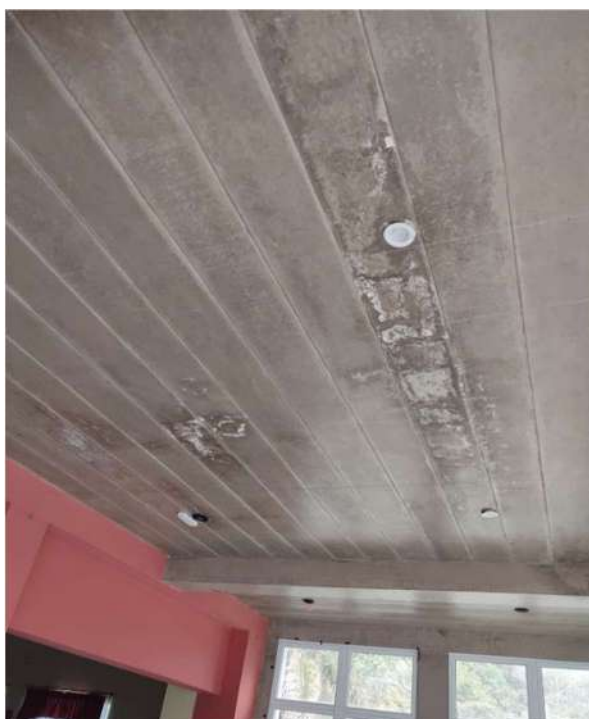
Imagem: Teto com (possível) eflorescência
