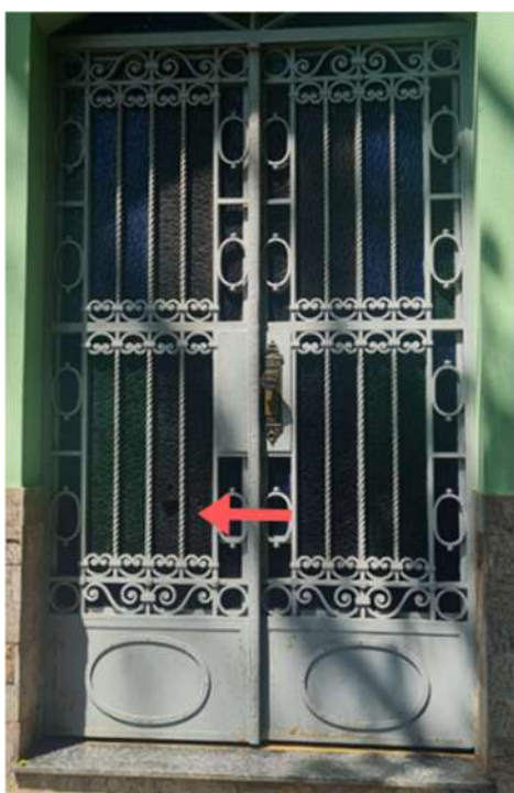
Imagem: Porta com vidro quebrado
