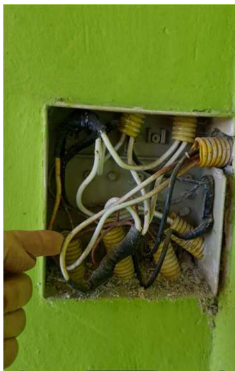
Imagem: falta espelho - fiação rígida
