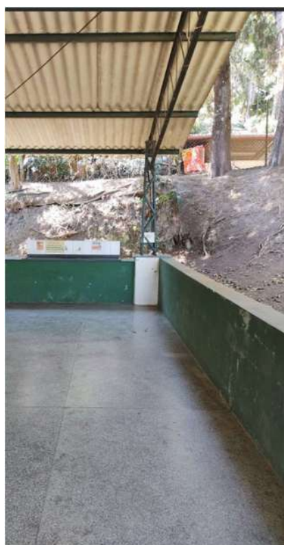
Imagem: paredes umidade ascendente
