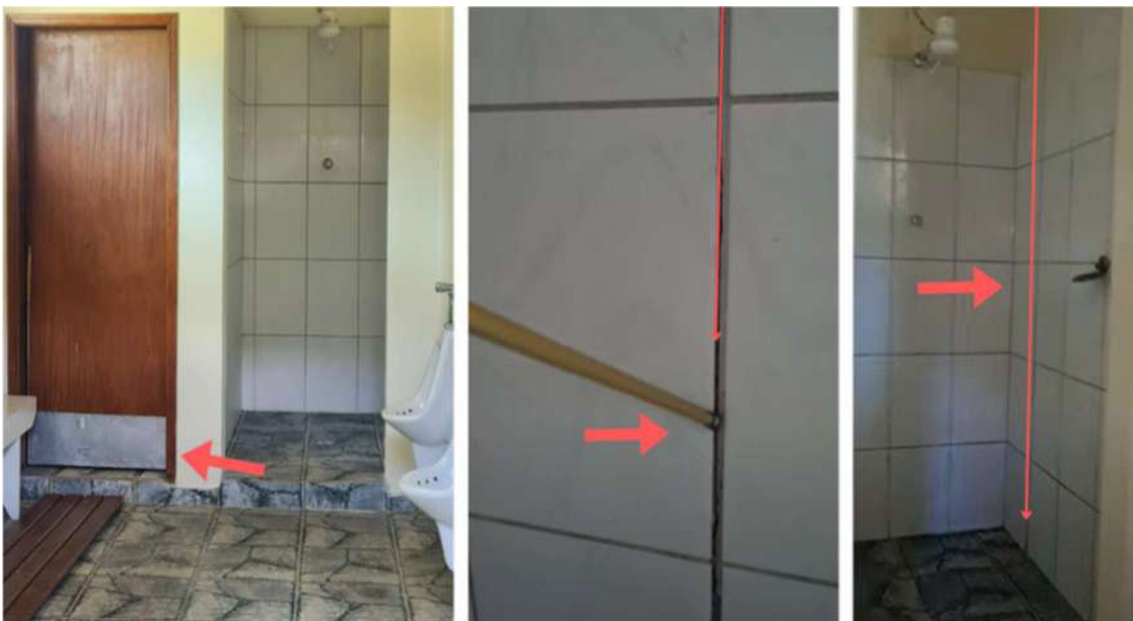
Imagem: Interior do vestiário masculino – remendo na porta e trinca vertical
