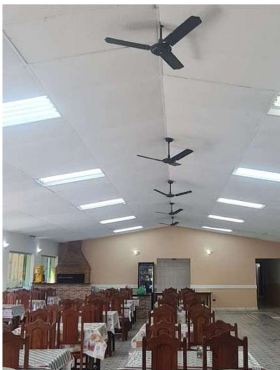
Imagem: Ventiladores inoperantes
