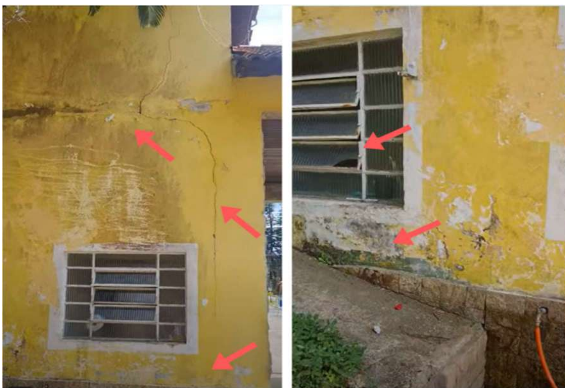
Imagem Fachada externa – trincas, umidade ascendente, pintura danificada
