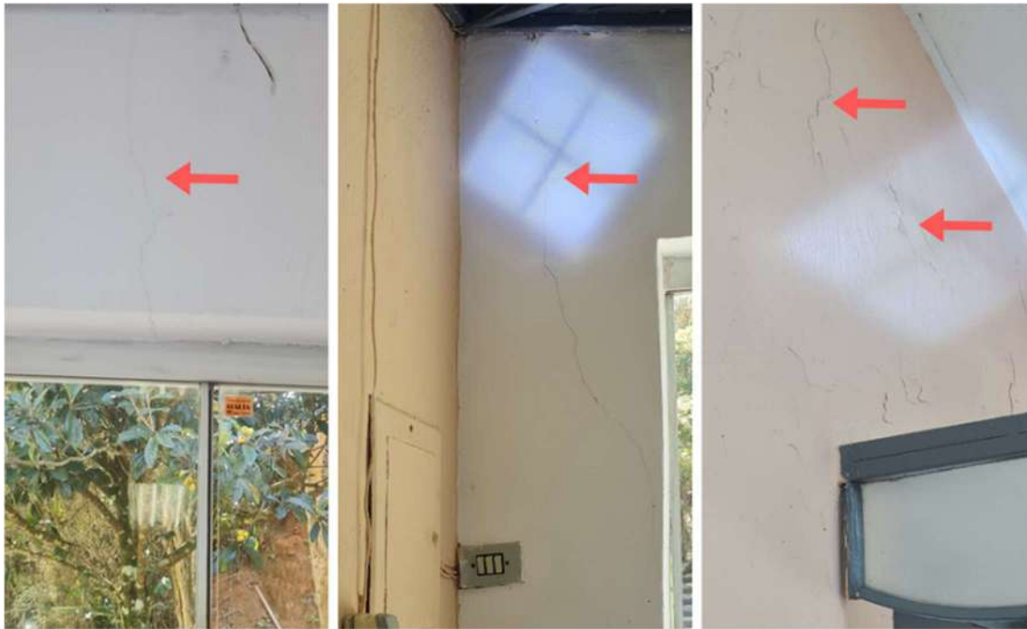
Imagem: Fissuras e descolamento de pintura
