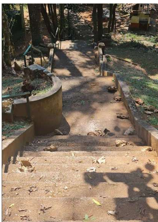
Imagem: Ausência de corrimão de ambos os lados
