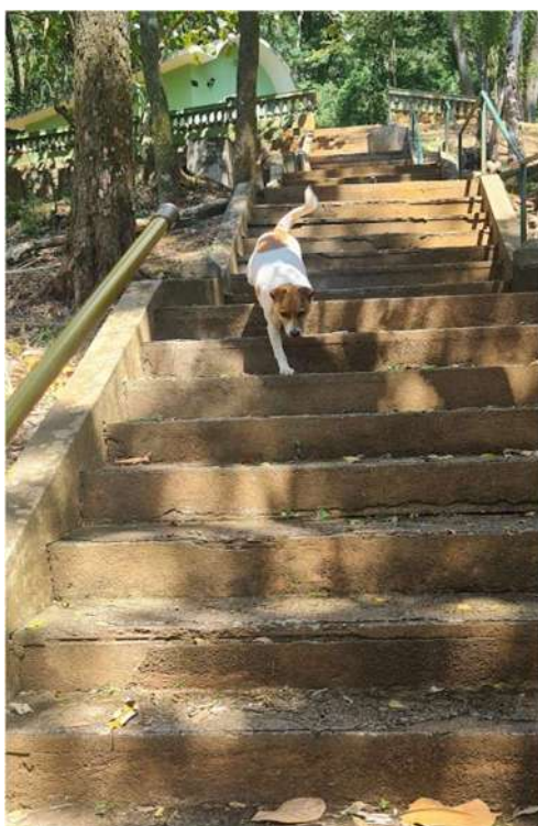
Imagem: Acesso – danificado
