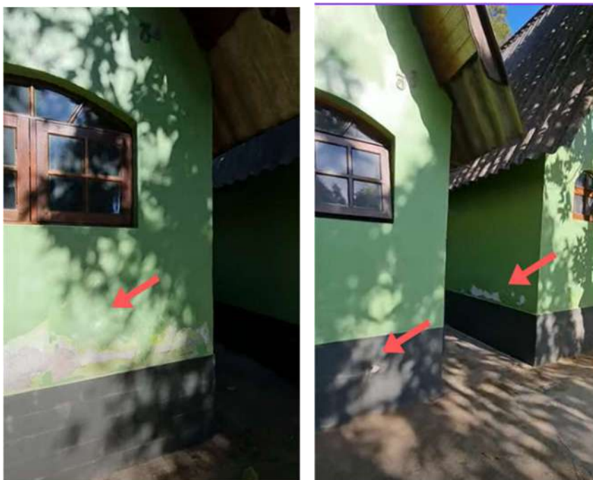
Imagem: Desgastes pontuais nas fachadas dos Chalés
