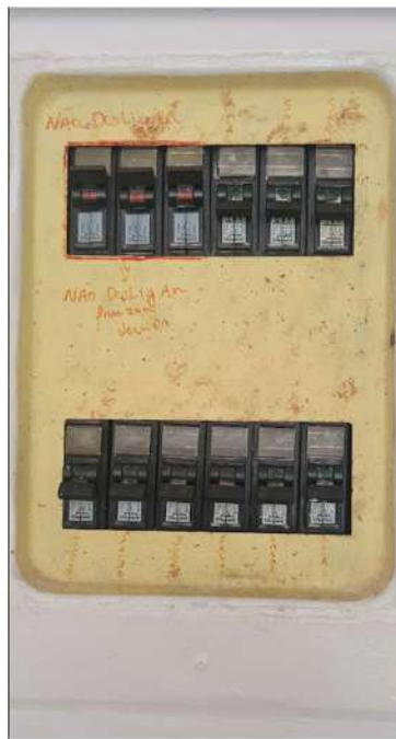
Imagem: Quadros de força
