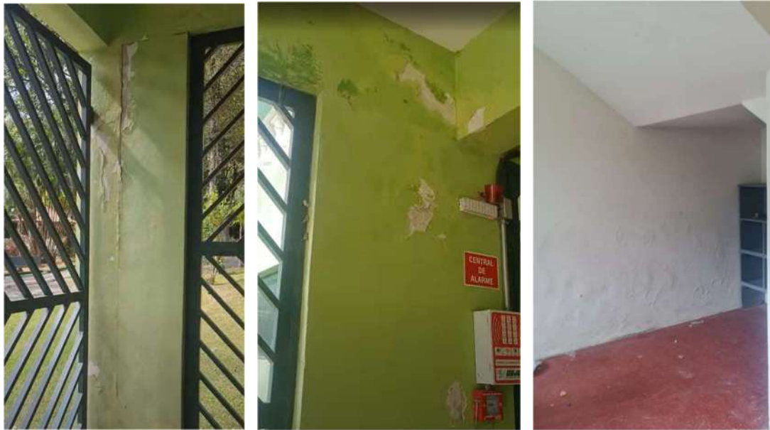
Imagem: Vários locais com pintura danificada pela umidade
