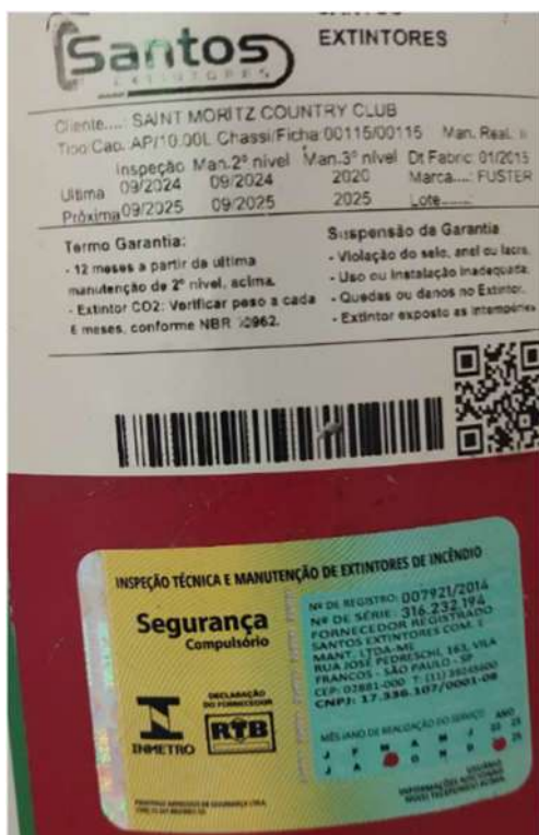
Imagem: Extintor – segurança OK
