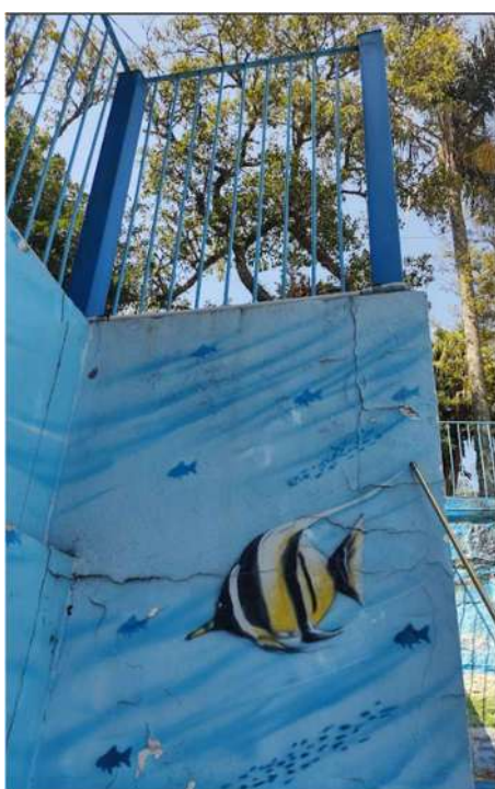
Imagem: Trincas aparentes
