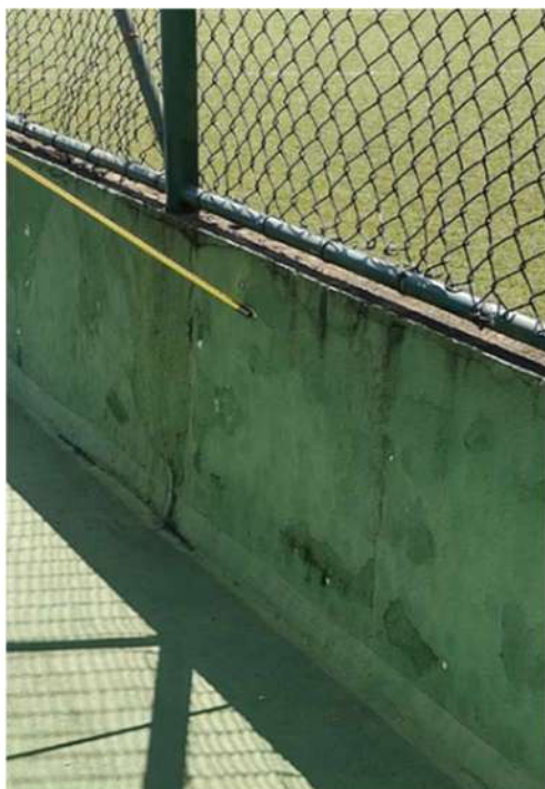
Imagem: Umidade, trincas
