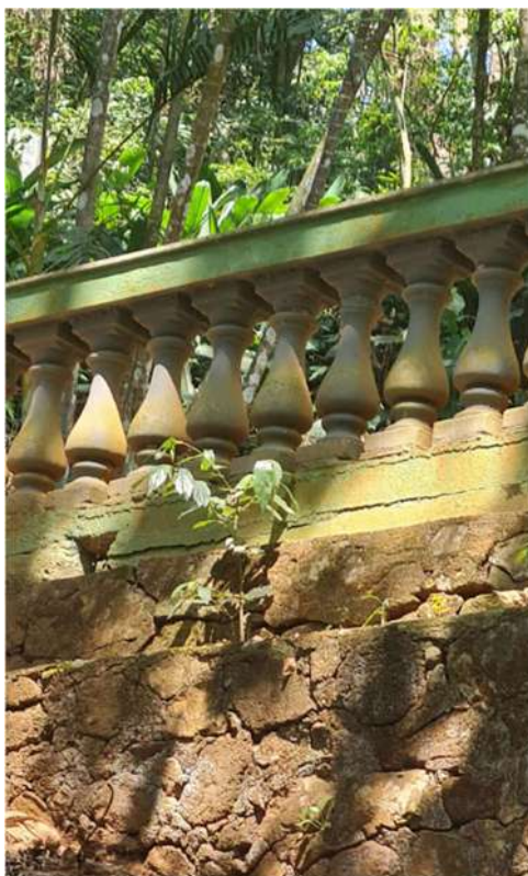
Imagem: Balaústre – base trincada
