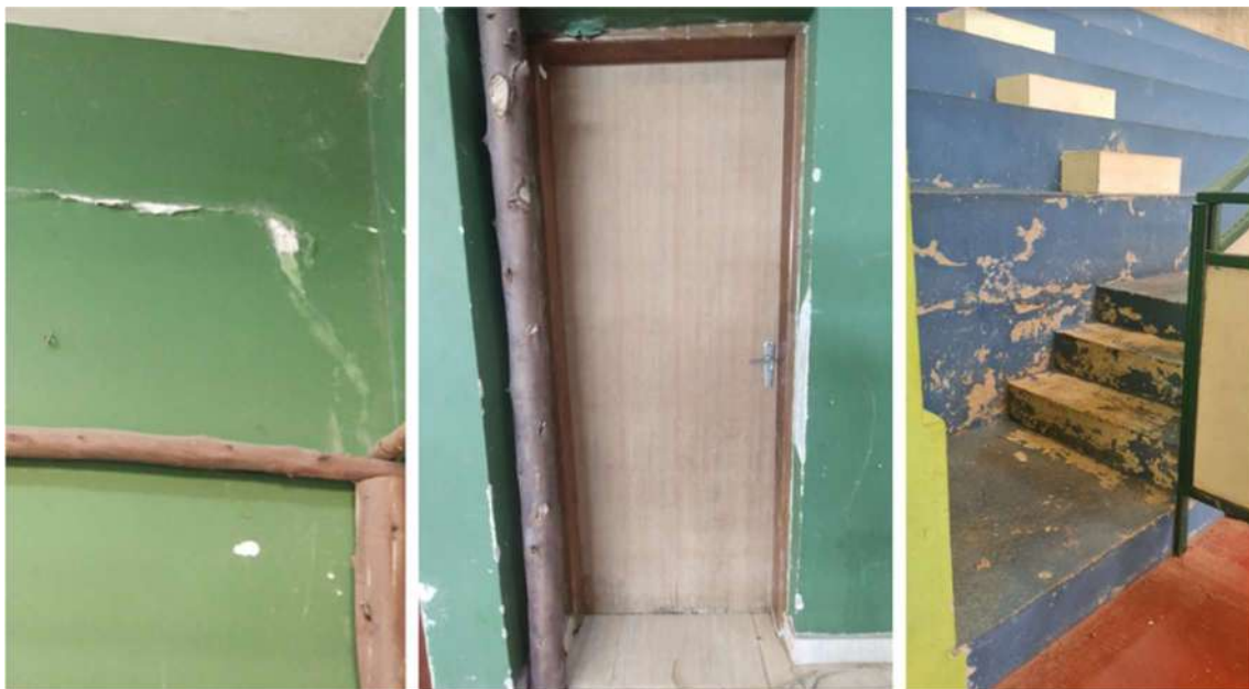
Imagem: Pintura e reboco danificados
