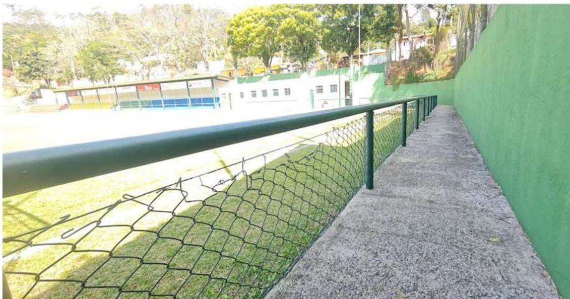
Imagem: Circulação ao redor do campo – pintura bom estado, alambrado em alguns pontos soltos
