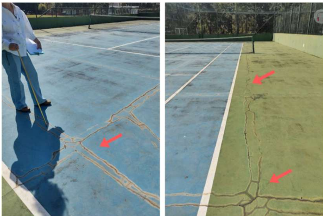
Imagens: Quadra tênis Piso danificado
