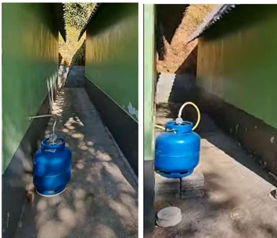
Imagem: Botijões expostos sem proteção e umidade ascendente
