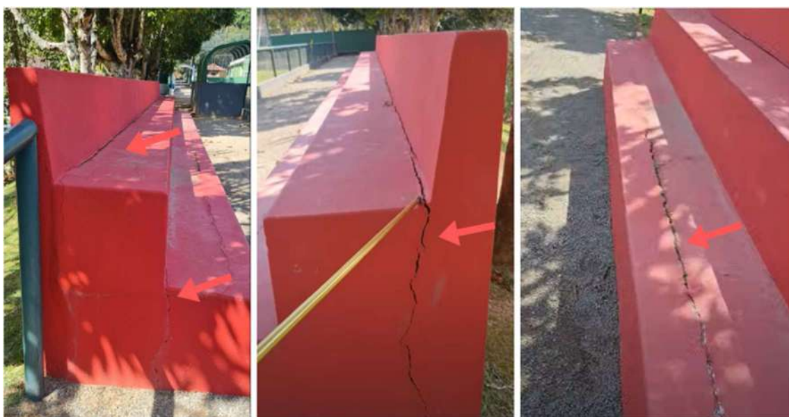
Imagem: banco alvenaria trincado integral longitudinalmente e verticalmente
