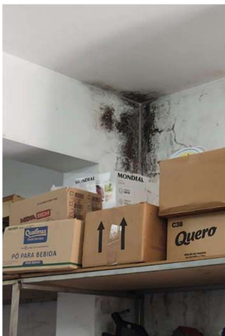
Imagem: Umidade cozinha
