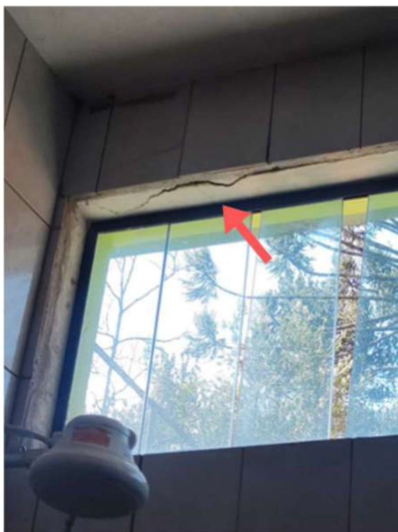
Imagem: Rachadura aparente
