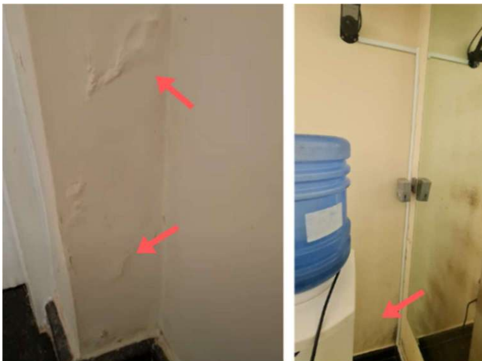
Imagem Estufamento da pintura e umidade ascendente
