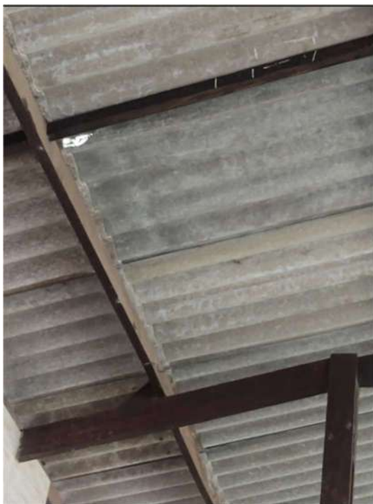
Imagem: furo telha
