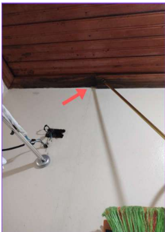
Imagem: Forro danificado
