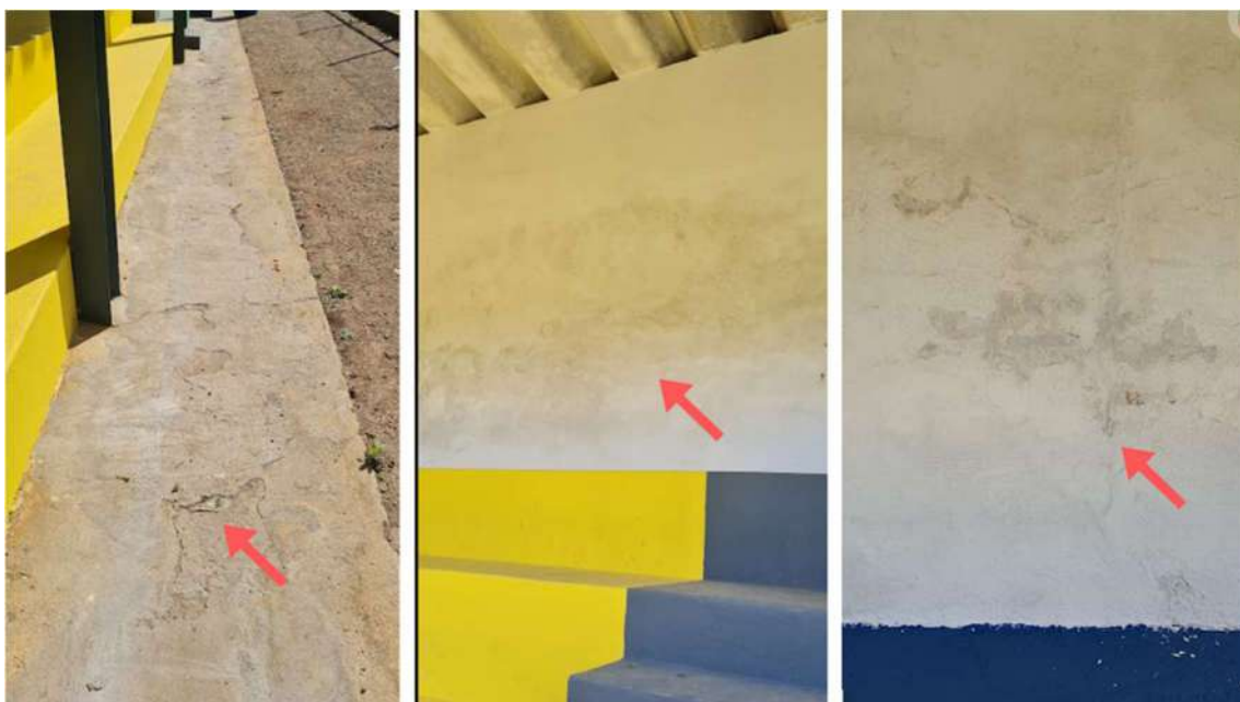
Imagem Arquibancada desgaste natural piso e umidade na parede
