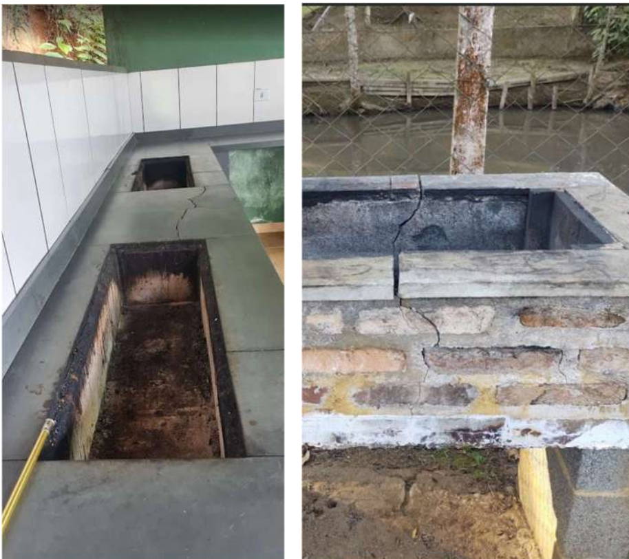
Imagem: Churrasqueiras com pedra superior ou estruturas trincadas
