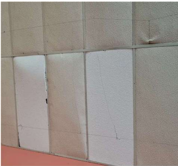
Imagem: Forro desigual e com avarias
