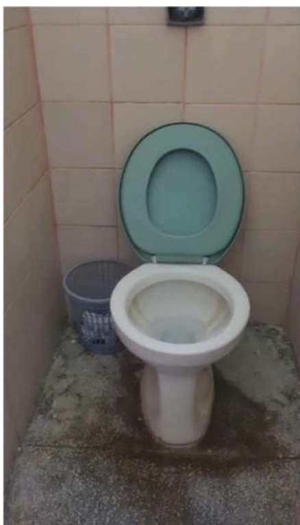
Imagem: Wc piso manchado/ válvula sem acabamento
