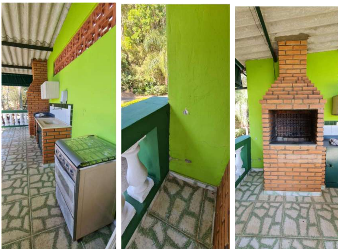
Imagem: Espaço com churrasqueira – excelente estado – guarda corpo com trinca
