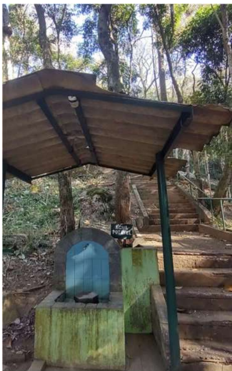
Imagem: Fonte de água potável – Cobertura muito danificada, visual não atrativo para associados.
