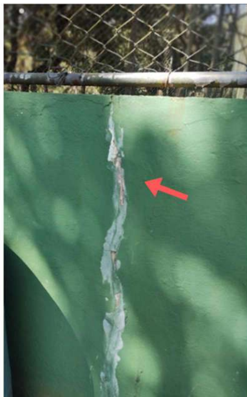
Imagem: Fissura/ pintura danificada
