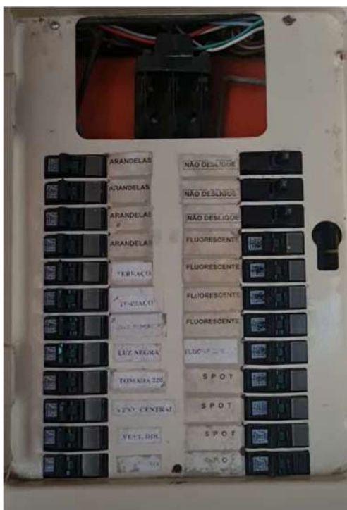
Imagem: Quadro de força identificado
