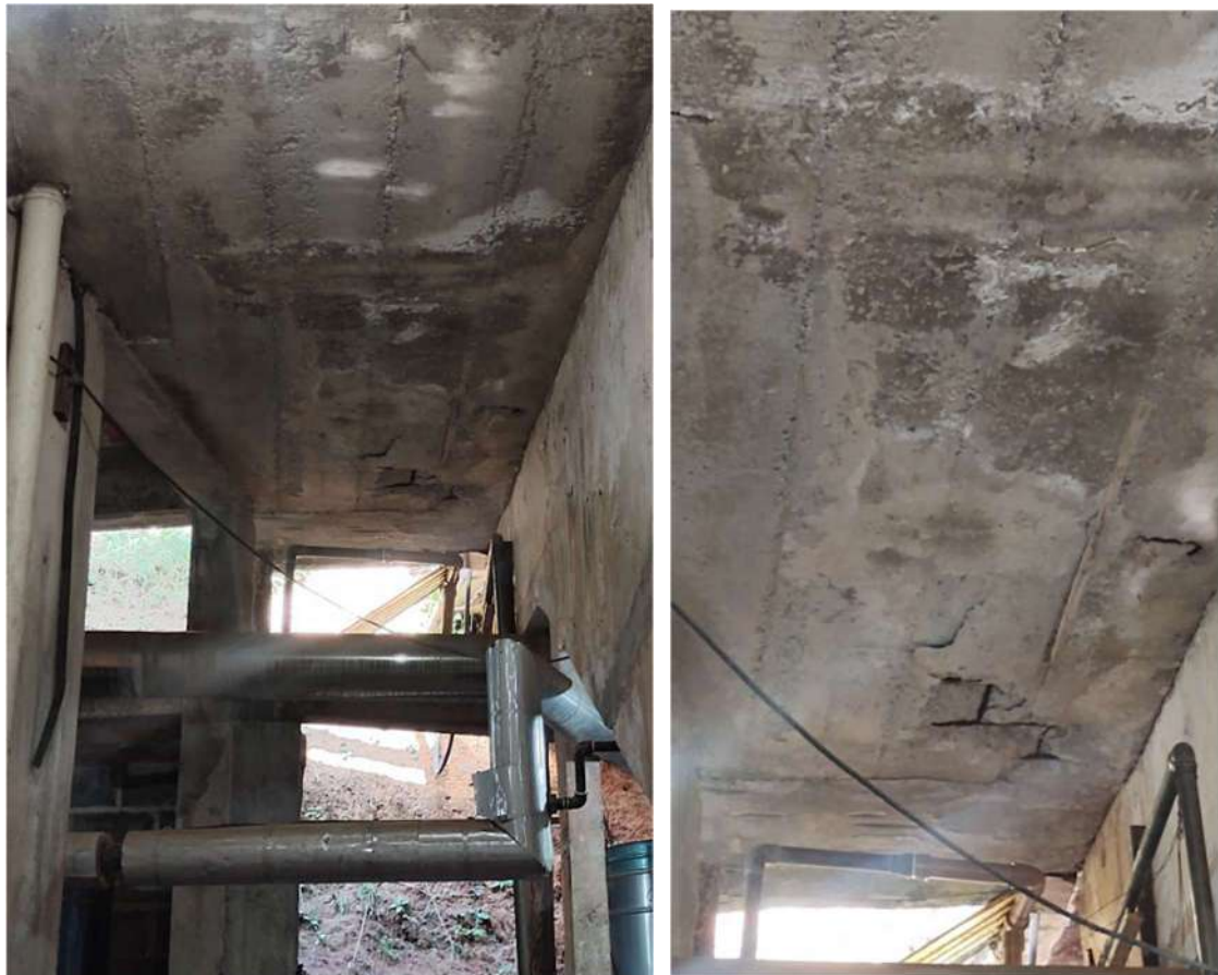
Imagem: Externo a sauna – demanda avaliação de perito estrutural
