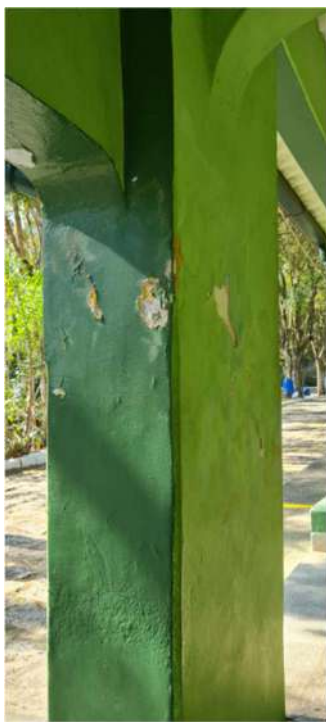
Imagem: Pilar com umidade
