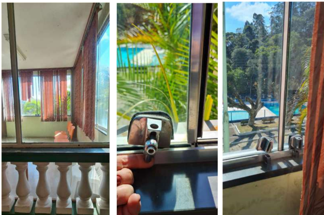
Imagens: sala tv – cortina e trincos danificados
