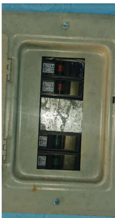
Imagem: Quadro de força
