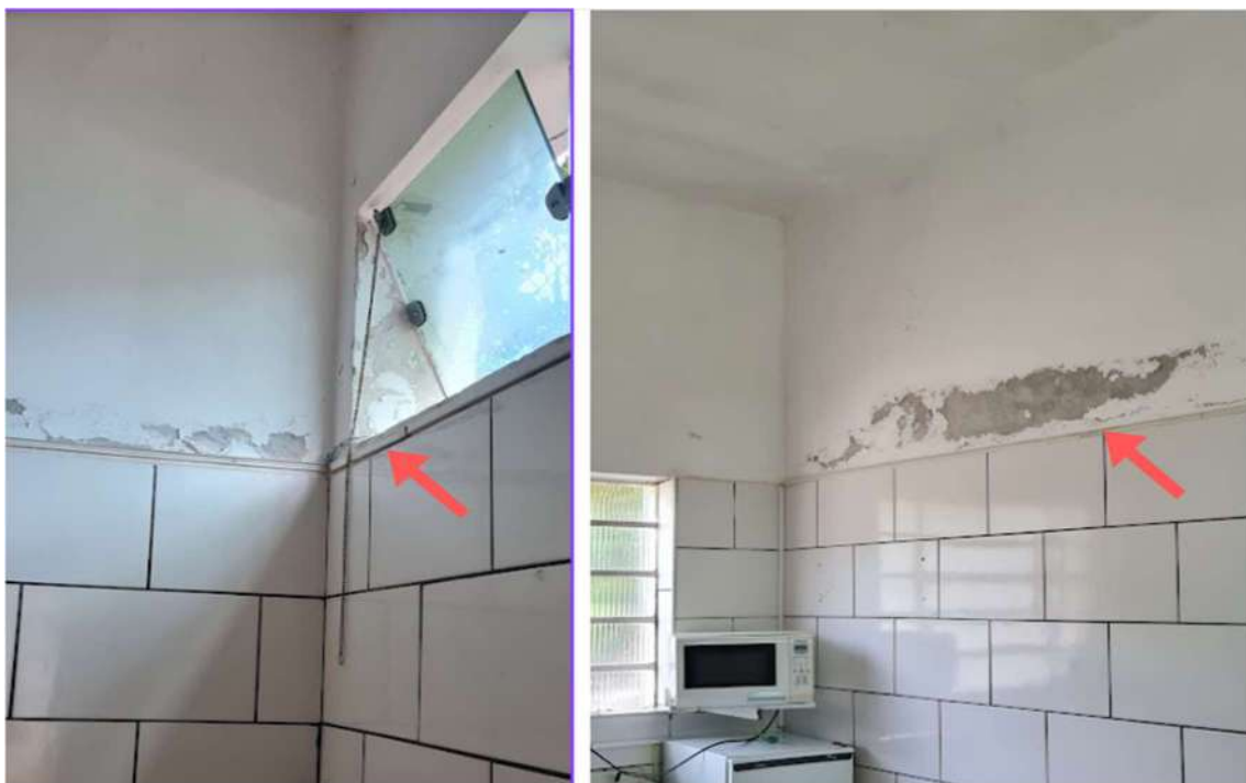
Imagens: copa funcionários – pintura danificada interna e externa
