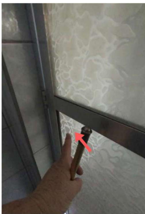
Imagem: Fechamento portas banheiros soltos
