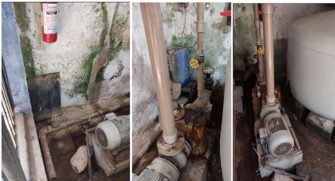
Imagem: Casa de máquinas - com tempo de serviço elevado
