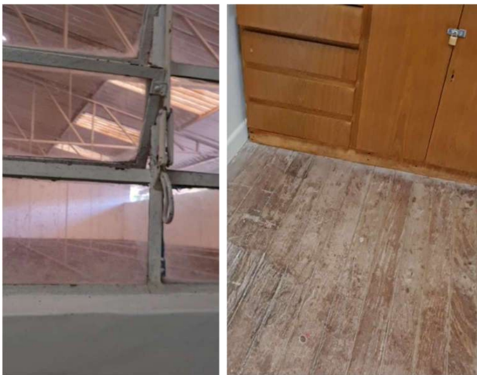
Imagem: Sala troféus – vitrô e piso danificados
