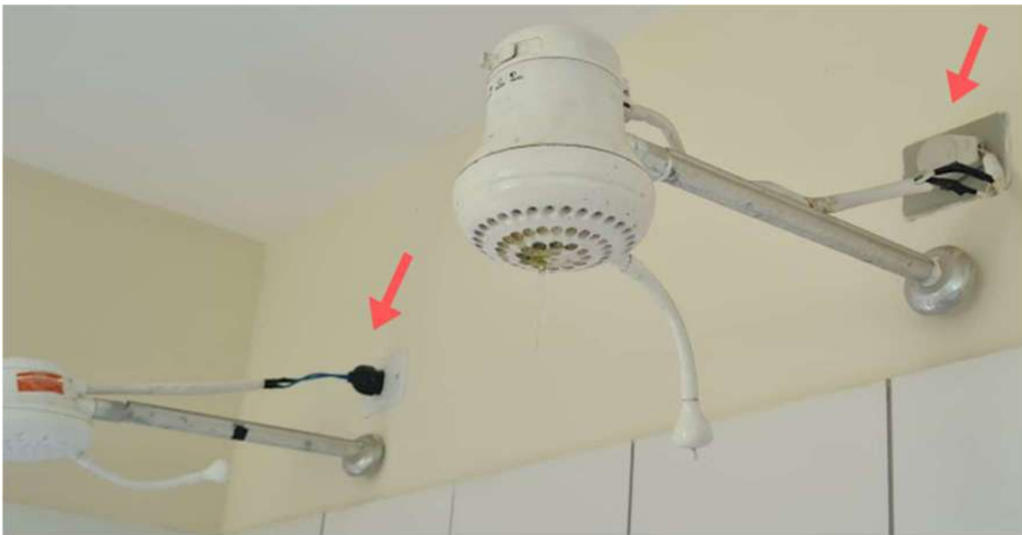
Imagem: Ligação elétrica inadequada nos chuveiros
