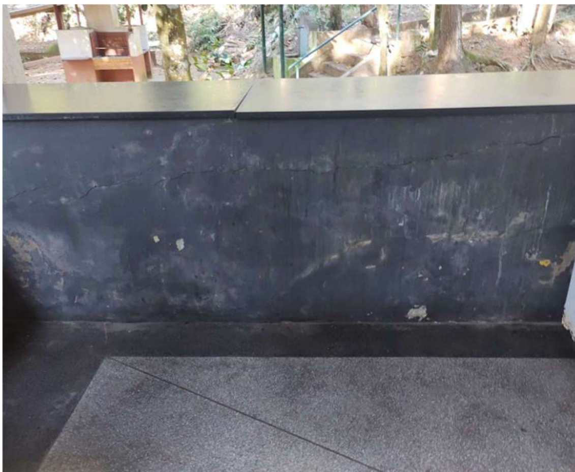
Imagem: Muretas dos quiosques apresentam umidade ascendente
