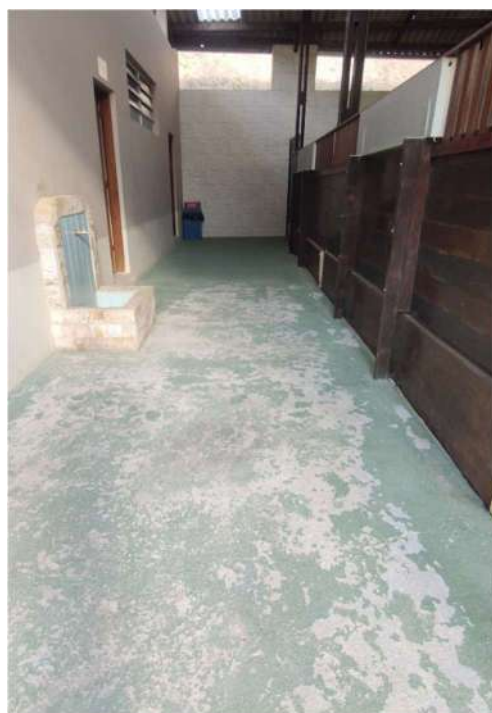
Imagem: Piso desgastado na pintura
