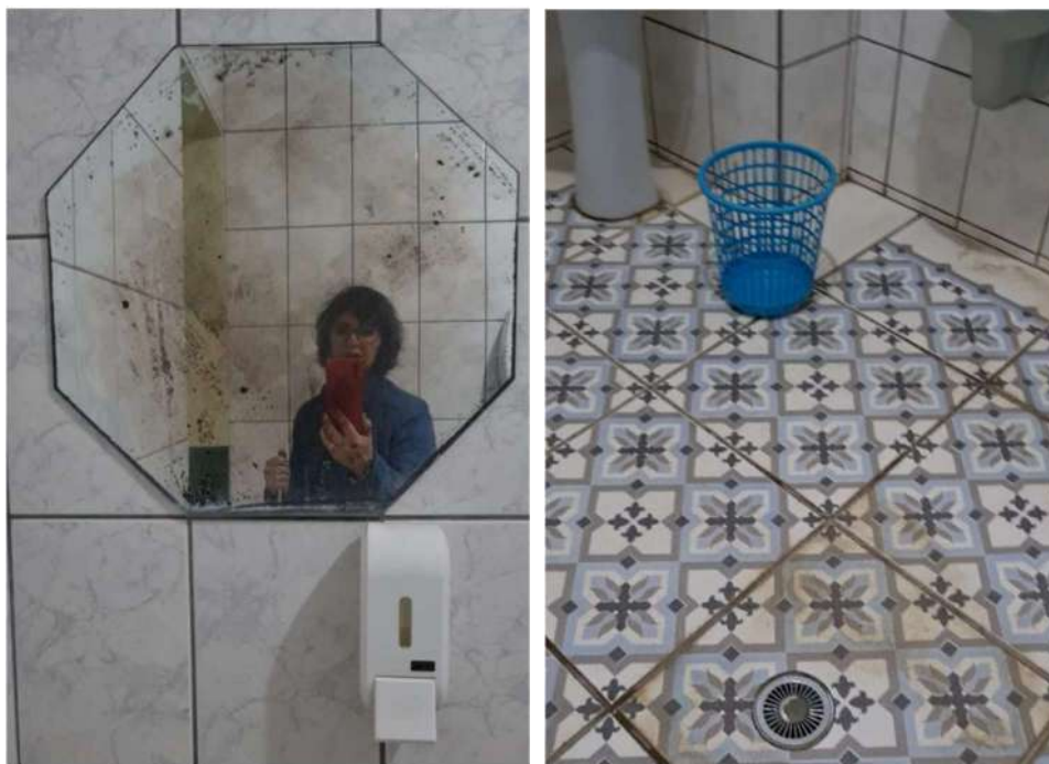
Imagem: Banheiro masculino – espelho sinais de desgaste e piso manchado
