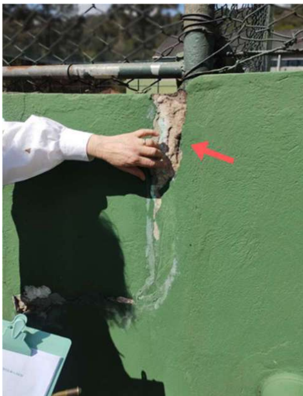
Imagem: Infiltração/ pintura danificada
