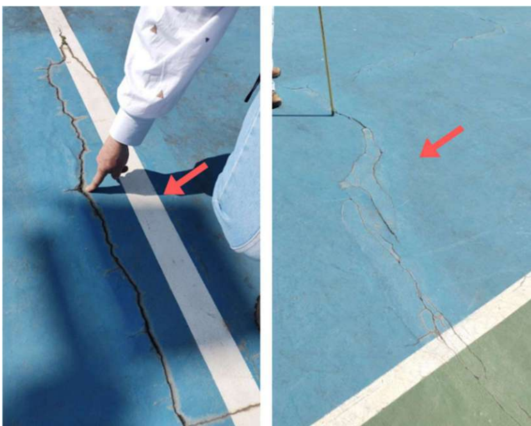
Imagens: Piso danificado
