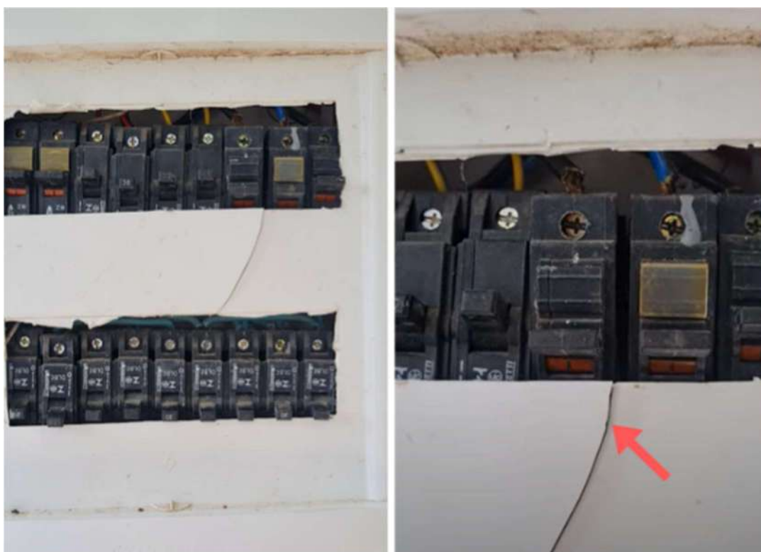
Imagem: Quadro força trincado, fios rígidos
