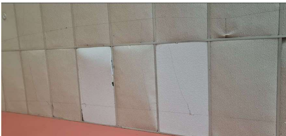
Imagem: Forro em gesso apresenta estado de desgaste
