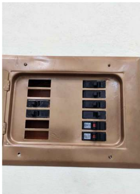
Imagem: Quadro força- não identificada iluminação
