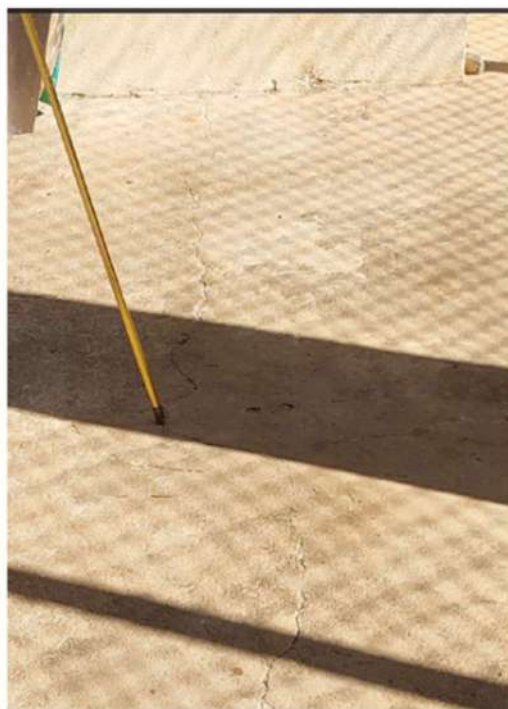
Imagem: Piso cimentado danificado
