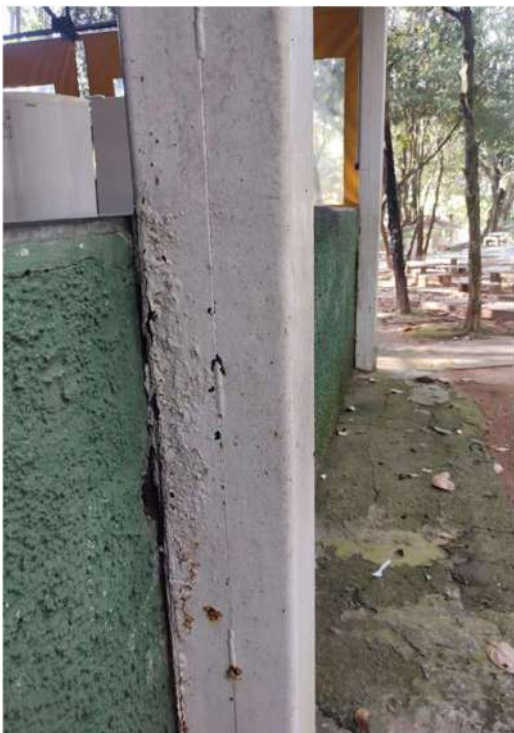
Imagem: Pilar metálico corrosão
